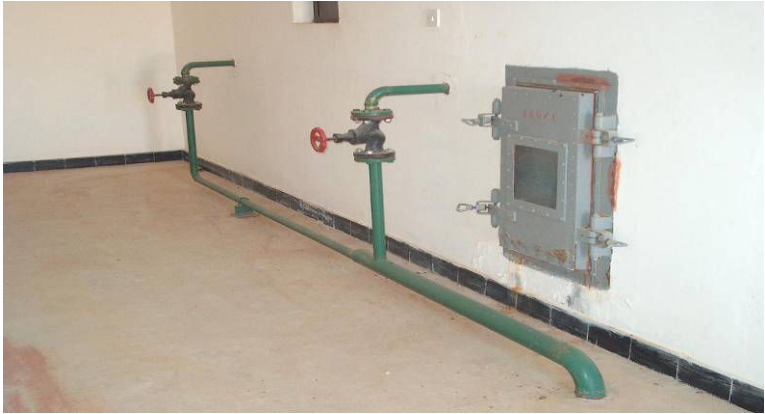
Figure - 8 - L'entrée d'eau du laveur d'air (partie supérieure)
