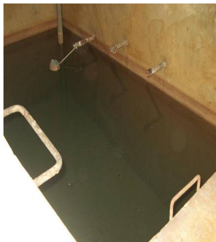
Figure – 7 - La piscine du laveur d'air
