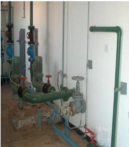
Figure – 6 - Les pompes de laveur d'air
